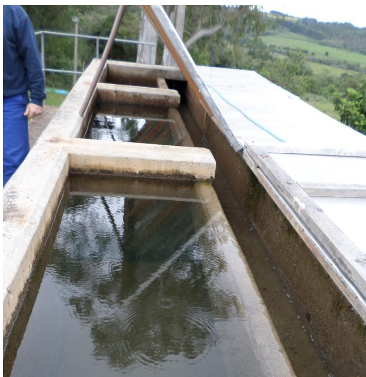
Figura 9 - Estação de tratamento do município de Morro Redondo
