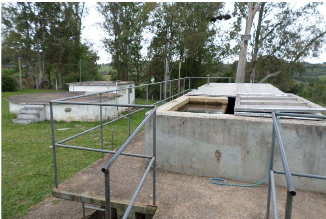
Figura 8 - Estação de tratamento do município de Morro Redondo
