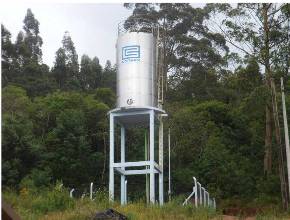
Figura 12 - Reservatório R3 de água de Morro Redondo
