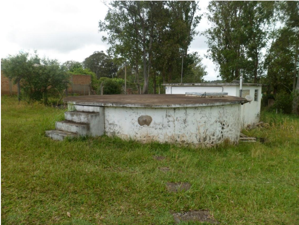
Figura 10 - Reservatório R1 de água de Morro Redondo
